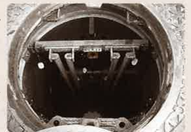
マンホールポンプ
