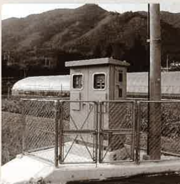
マンホールポンプの制御盤
