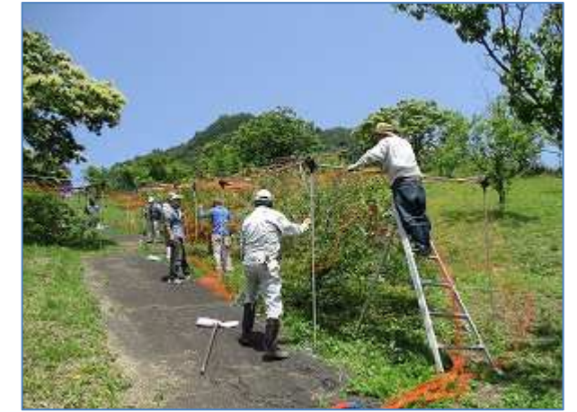
食農体験教室「親子でブルーベリージャム作り」講座のためブルーベリー園に防鳥ネットを設置した。
